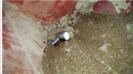
FSA - Sensor in einem Sandsilo. Die Sonde befindet sich direkt im Materialstrom. Sand-Dichteunterschiede sind an dieser Messposition vernachlässigbar. (Innenansicht)
