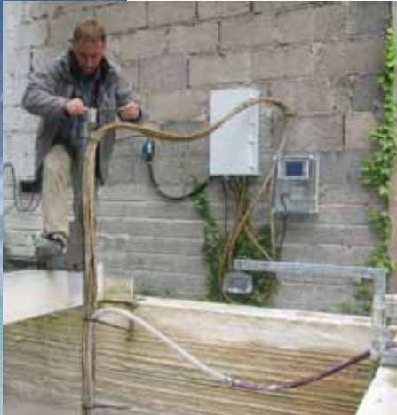
Installation des Tauch-Messkopfes in ein Restwasserbecken. Im Hintergrund: Auswerteeinheit und optionale Anzeige (TPC)
