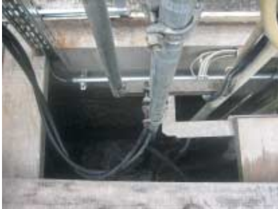
Fig. 5 Tube for mounting the measuring head sensor in the tank. Abb. 5 Befestigungsrohr für den Sensormesskopf im Becken.
