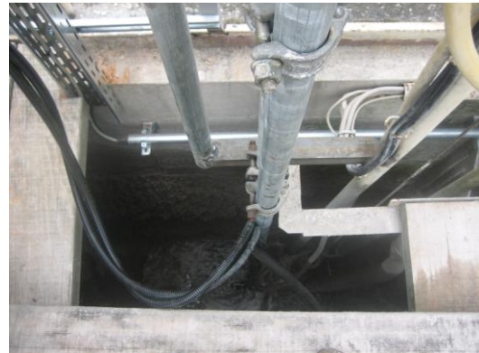
Befestigungsrohr für den Sensormesskopf im Becken
