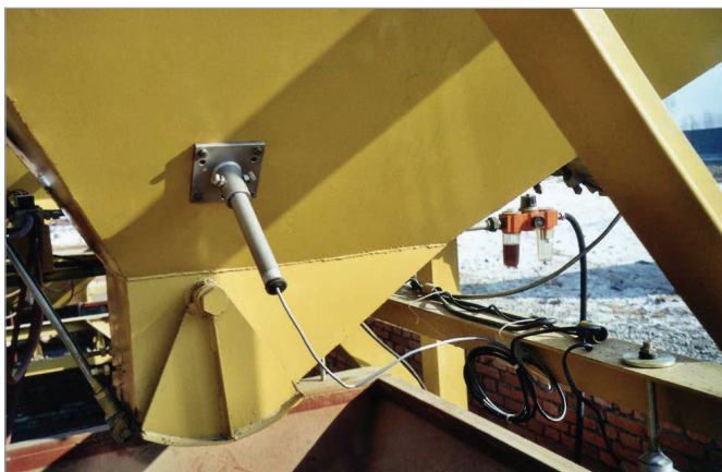
Äußere Befestigung einer Sonde am Silo
