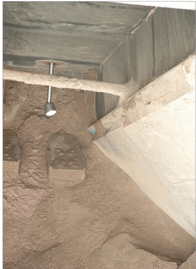
Feuchtemess-Sonde im Silo
