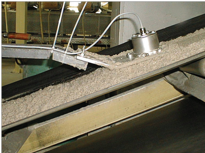
Feuchtemess-Sonde auf einem Schlitten im Förderbandeinsatz
